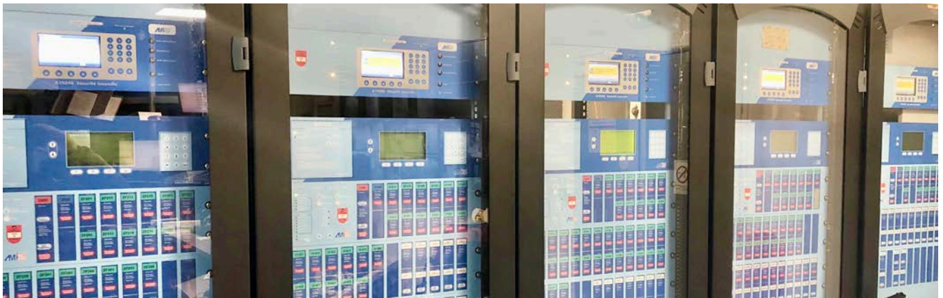
Installation SSI en réseau réalisée par AMI2S comportant plus de 3000 points de détection automatique ou manuelle
